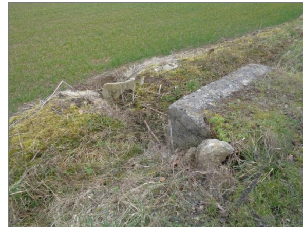
Figure 10 : Buse d'écoulement des eaux
