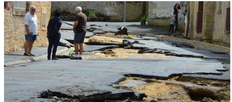
📍 Vernou-sur-Brenne, rue Neuve suite inondation
