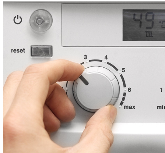
Température de consigne de la chaudière
